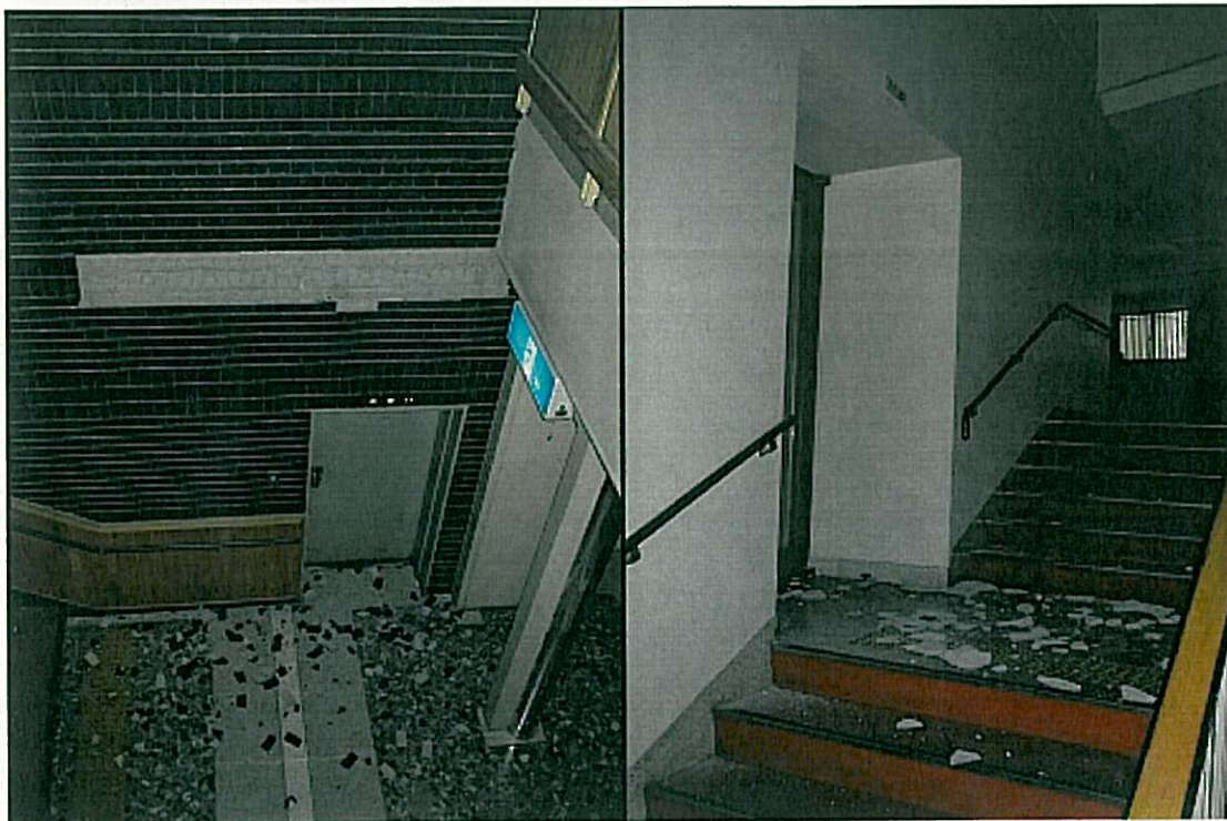
(3)ロビー…タイルが多量に剥がれ落ちた
