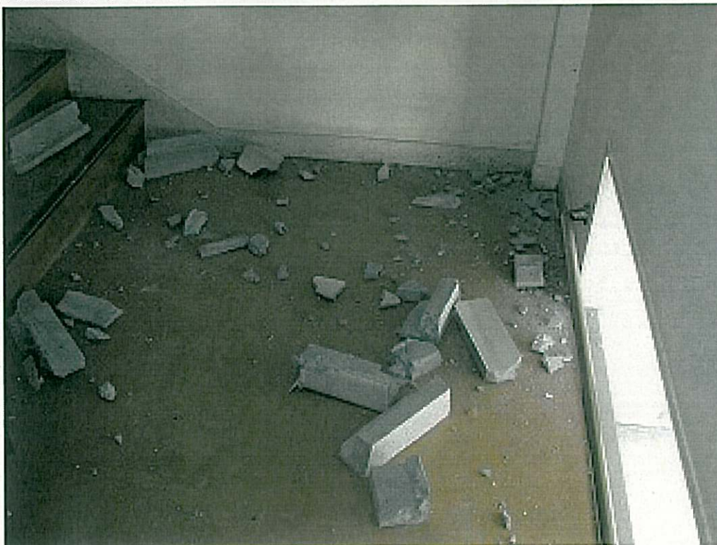
(4)会議室棟…6階西側柱転倒, 3階壁面陥没, 各階階段踊り場コンクリート片多数落下, 4階芸術協会非常灯落下
